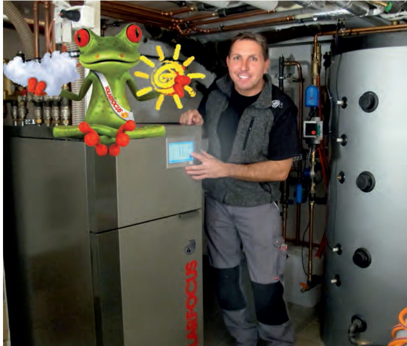
Helmut Ehrle mit einem Heizkessel mit Wetterfroschfunktion - Foto Frosch: SOLARFOCUS
